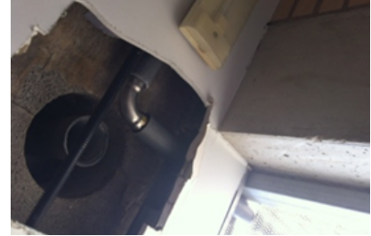
Fig. 37 - Instalación interior alojada en vaina
