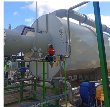
Fig. 38b - Instalación exterior industrial
