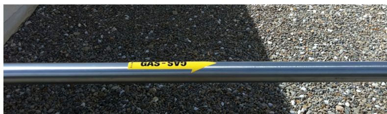
Fig. 13 - Instalación de gas
