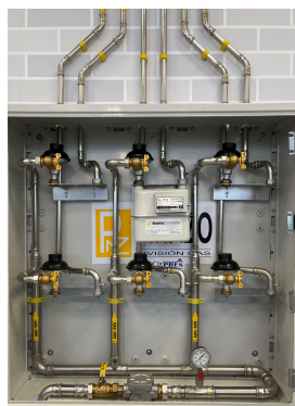
Fig. 29a - Armario contador
